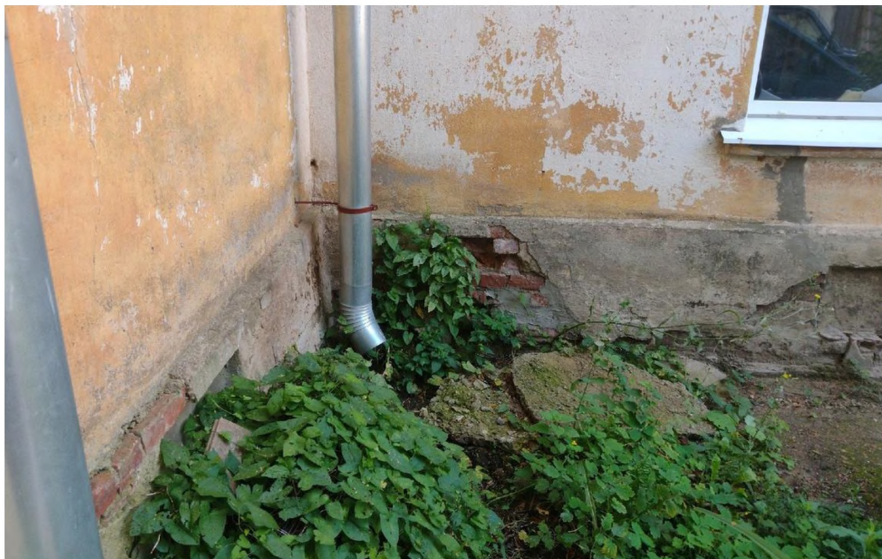
№ 16. Северо-западный угол северного фасада. Вид на разрушенную отмостку и деструкция кирпичной кладки в цокольной части Фото сентябрь 2023 г. (Ефимова Ч.А.)
