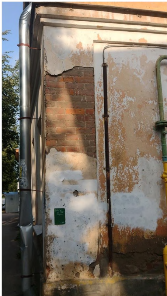
№ 7. Деструкция штукатурки на юго-восточной лопатке фасада. Восточный фасад. Фото сентябрь
