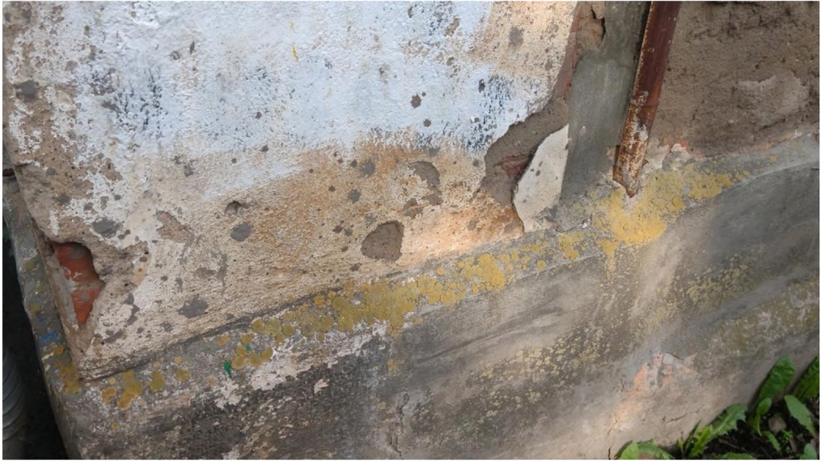
№ 10. Следы лишайника на цоколе. Восточный фасад. Фото сентябрь 2023 г. (Ефимова Ч.А.)
