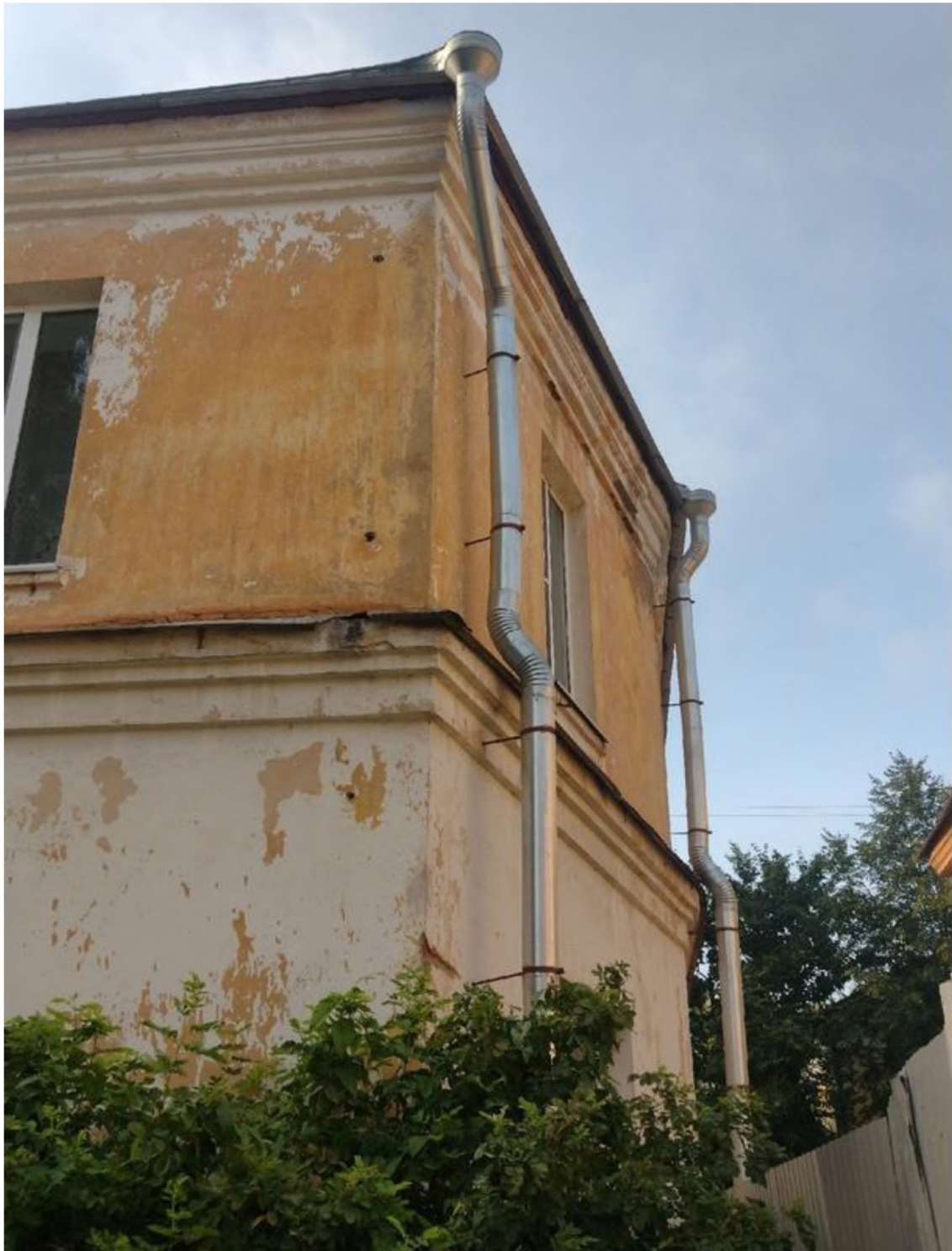
№ 18. Скошенный северо-западный угол здания. Фото сентябрь 2023 г. (Ефимова Ч.А.)
